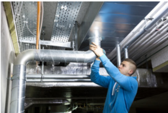
Source suissetec : constructeur d'installations de ventilation
